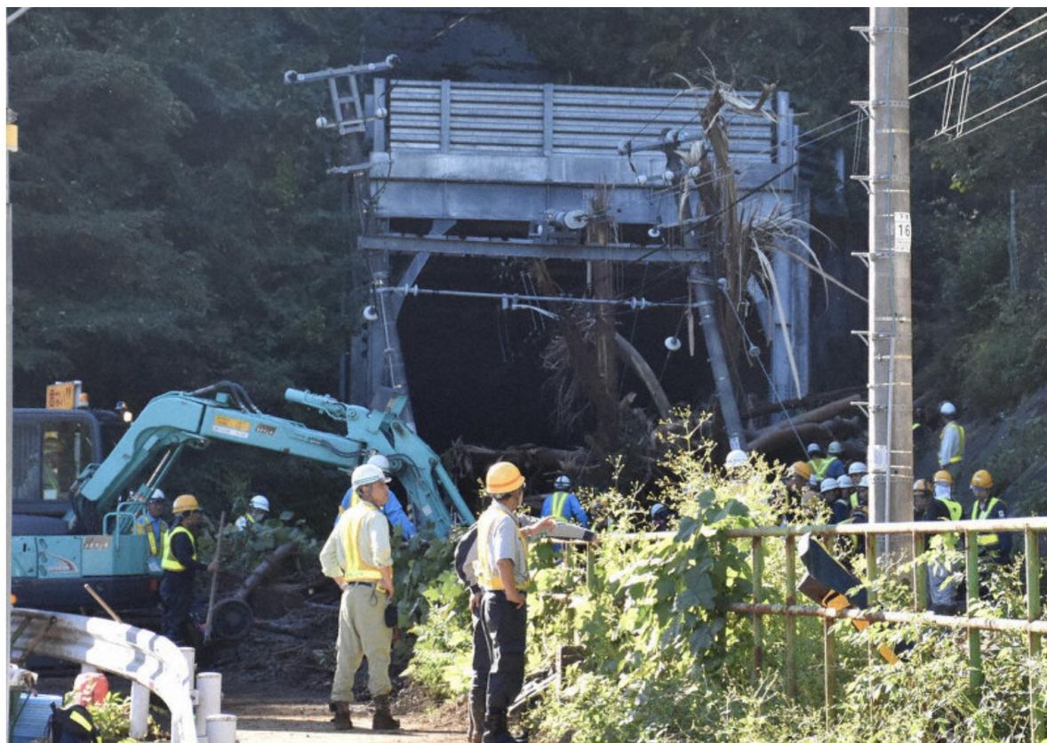
土砂や倒木が流入したJR中央線梁川-四方津間の線路では撤去作業が進められた=山梨県大月市で13日午後2時14分
